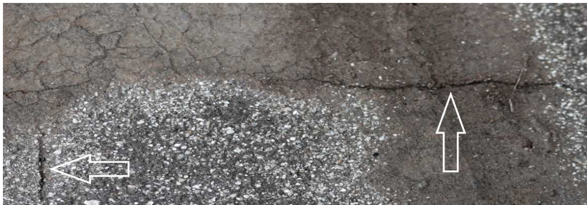
Zdj.3 - pęknięcia starej powłoki hydroizolacji oraz podłoża
